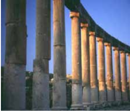
ب أضرار وتشوهات في أعمدة جرش نتيجة تعرضها للهزات الأرضية الذي حصل عام 749 AD
