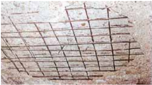
انهيار وتصدع البلاطات نتيجة صدأ الحديد
