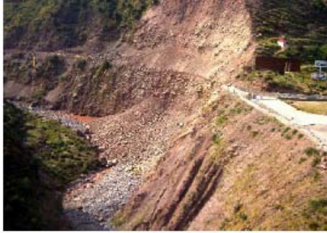
شكل (6.6) : انهيار وإغلاق الطرق في المناطق الجبلية نتيجة للانزلاقات الأرضية التي أحدثتها الزلازل (تقارير المعهد EERI)
